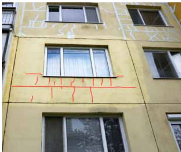
Obr. 1: Pohľad na obvodový plášť na báze pórobetónu porušený sieťou trhlin
