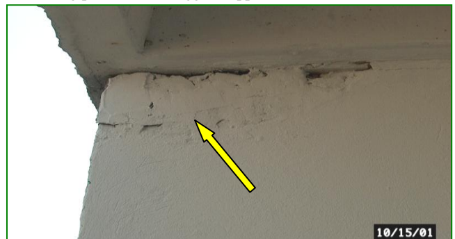
Poškodenie nosnej steny v uložení lodžiovej dosky Damage of the bearing wall in the mounting of a loggia board
