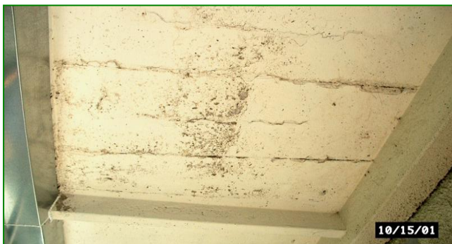
Trhliny a korózia výstuže v stropnej lodžiovej doske Cracks and corrosion of reinforcement in a ceiling loggia board
