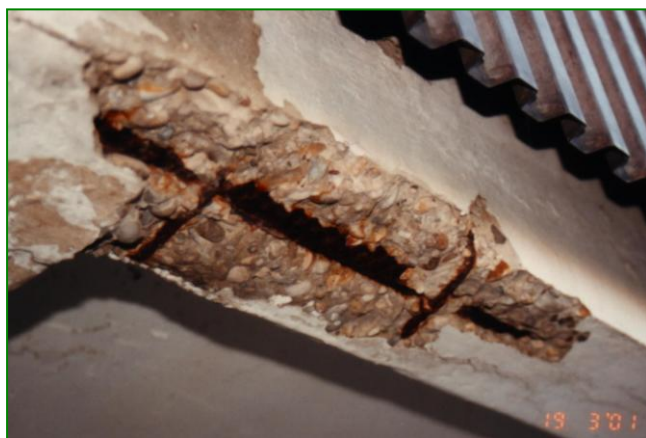
Zdegradovaný betón a skorodovaná výstuž Degraded concrete and corroded reinforcement
