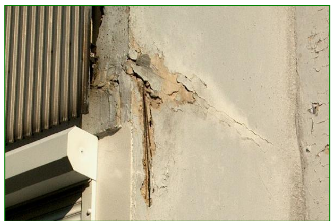
Zdegradovaná zálievka styku lodžiovej nosnej steny Degraded filler of the joint of a loggia bearing wall
