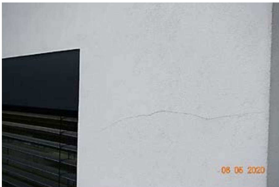
Obr. 2 - Trhlina ve vnějším souvrství ETICS na bázi MW se zapuštěnou montáží hmoždinek, vyvolaná teplotním smrštěním základní vrstvy při poklesu teploty
