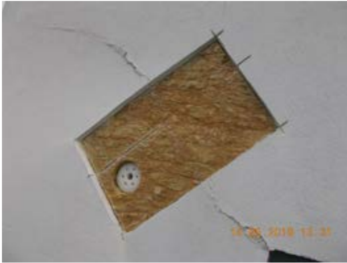
Obr. 2 - Sonda v místě trhliny. Izolant MW TR 10 dual density. Zápustná montáž se zátkou bez kontaktu talíř – základní vrstva dává vrchnímu souvrství nežádoucí „volnost pohybu“ při tepelné dilataci.
