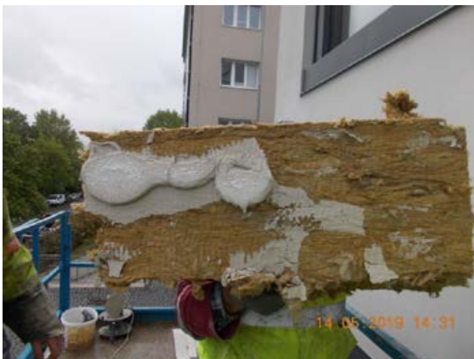
Obr. 6 - Potvrzení nefunkčního lepení na zaprášený pórobeton bez penetrace
