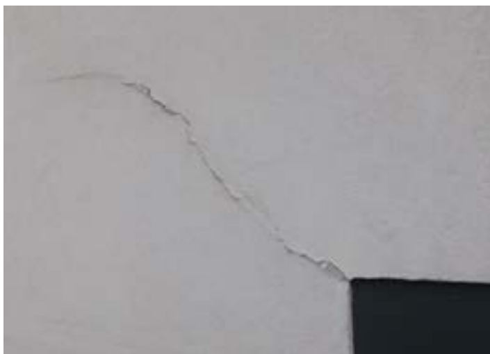
Obr. 1 - Aktivní trhlina v šířce nad 0,5 mm u krajního okna. Výztuž v místě opravy se po roce přetrhla. Délka fasádní plochy je cca 15 m
