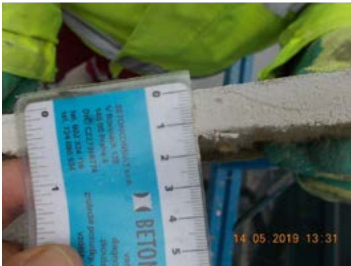
Obr. 3 - Zjištěná tloušťka vrchního souvrství je 12 mm. Důvod : Opakované vyrovnávání povrchu základní vrstvy, nesystémová „hladká“ omítka.
