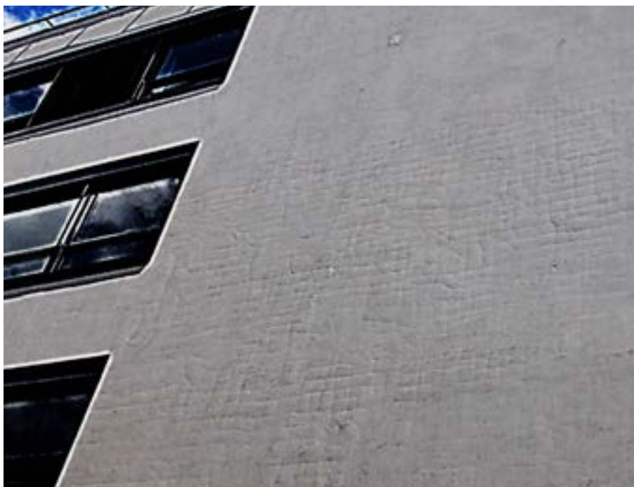
Obr. 3 - Poruchy vnějšiho souvrství ETICS, vyvolané jeho funkcí / konstrukcí jako plovoucí vrstva
